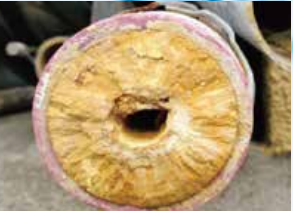
スケールが詰まった配管(例)
